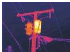
Przegrzanie transformatora słupowego
