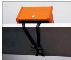
Rys.8: Mocowanie wskaźnika VisiVolt™ na szynie poziomej za pomocą opasek kablowych.
